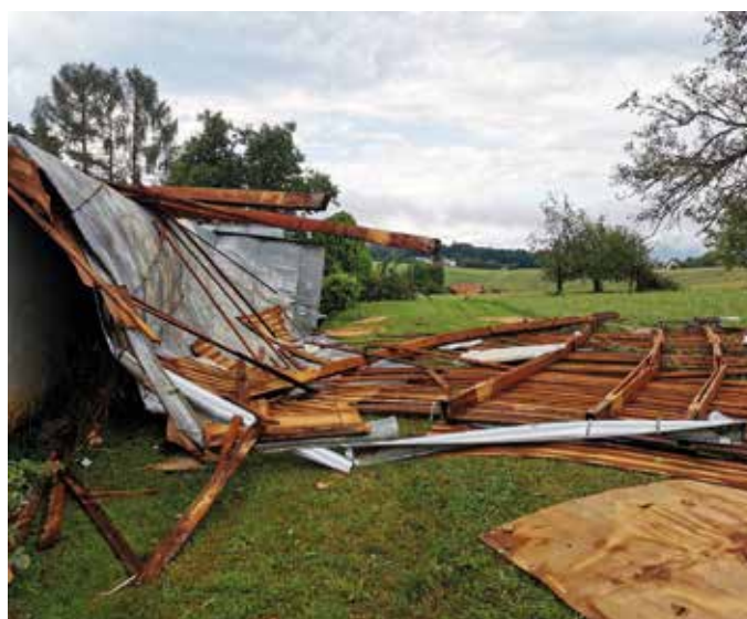
Ein vom Sturm abgedecktes Werkstättendach in Dienersdorf
